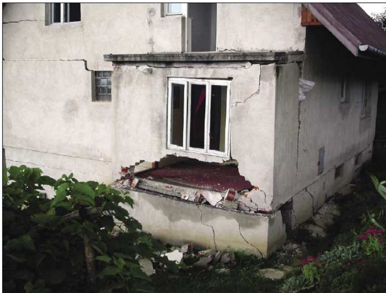
Niszczony dom mieszkalny w osiedlu Obłazy, gmina Chelmiec; lipiec 2001r.
